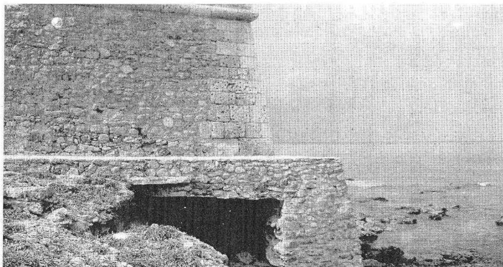
La base della torretta, conosciuta come Torre di Mezzo, erosa dal mare e dalle intemperie. FOTO MARCELLO DIGRANDI
